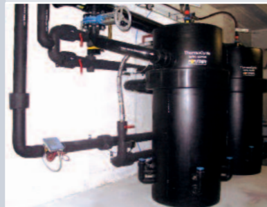
Wärmerückgewinnungsanlage im Hallenbad der Stadt Dornbirn
